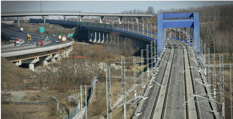
Cliente: C.A.V. TO-MI Progetto: Costruzione della Linea ferroviaria ad Alta Velocità To-Mi-tratta Brandizzo-Agognate-Biandrate
